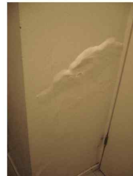
Kuva 61. Kellarissa on yhdessä kohtaa portaalla maakosteudesta johtuvia kosteusvaurioita ja rappaus on näissä kohdoin irronnut pohjasta.
