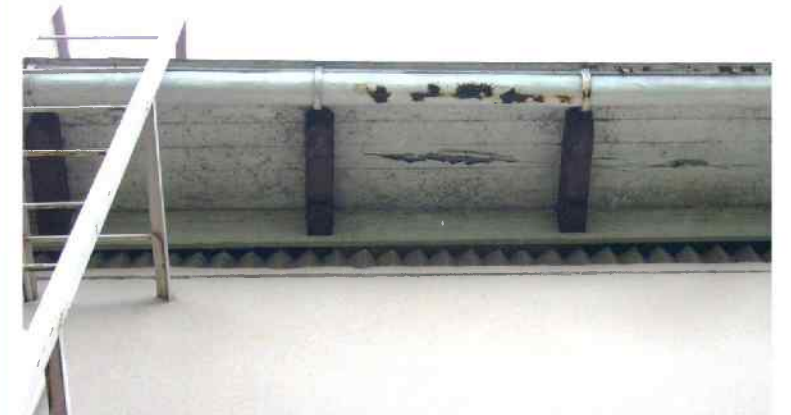
Kuva 61. Räystään alustan maali on paikoin lohekillut ja myös rännikouruissa on ruostetta maalauksen kuluttua.
